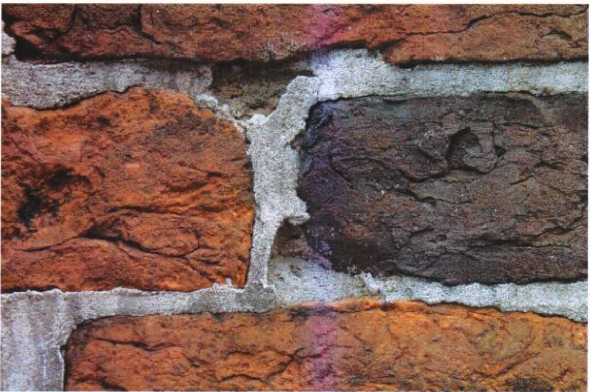
Fot.7. Grudziądz, pw. św. Mikołaja Bpa. Fragment wątku ceglanego z widoczną złuszczającą się warstwą wtórnej spoiny cementowej.
