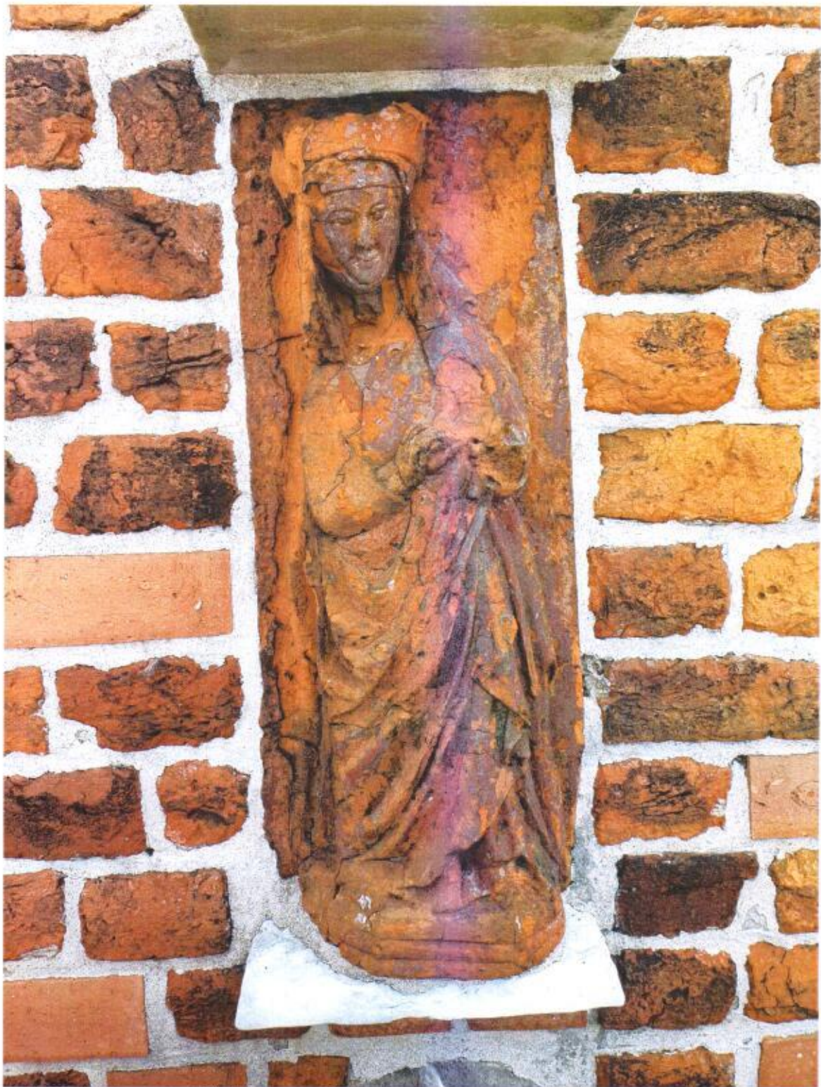
Fot.8. Grudziądz, pw. św. Mikołaja Bpa. Rzeźba Matki Boskiej. Widoczne rozległe złuszczenia lica. Ceramika jest silnie skorodowana o rozwiniętej powierzchni.
