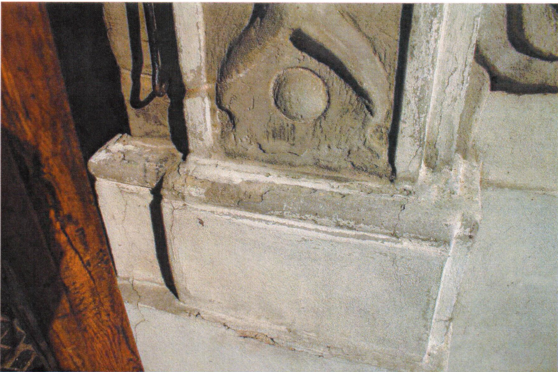
Fot.18. Grudziądz, Kościół pod wezwaniem św. Mikołaja, prawa strona portalu, złuszczonej zacierki odsłania uszkodzony kamień.
