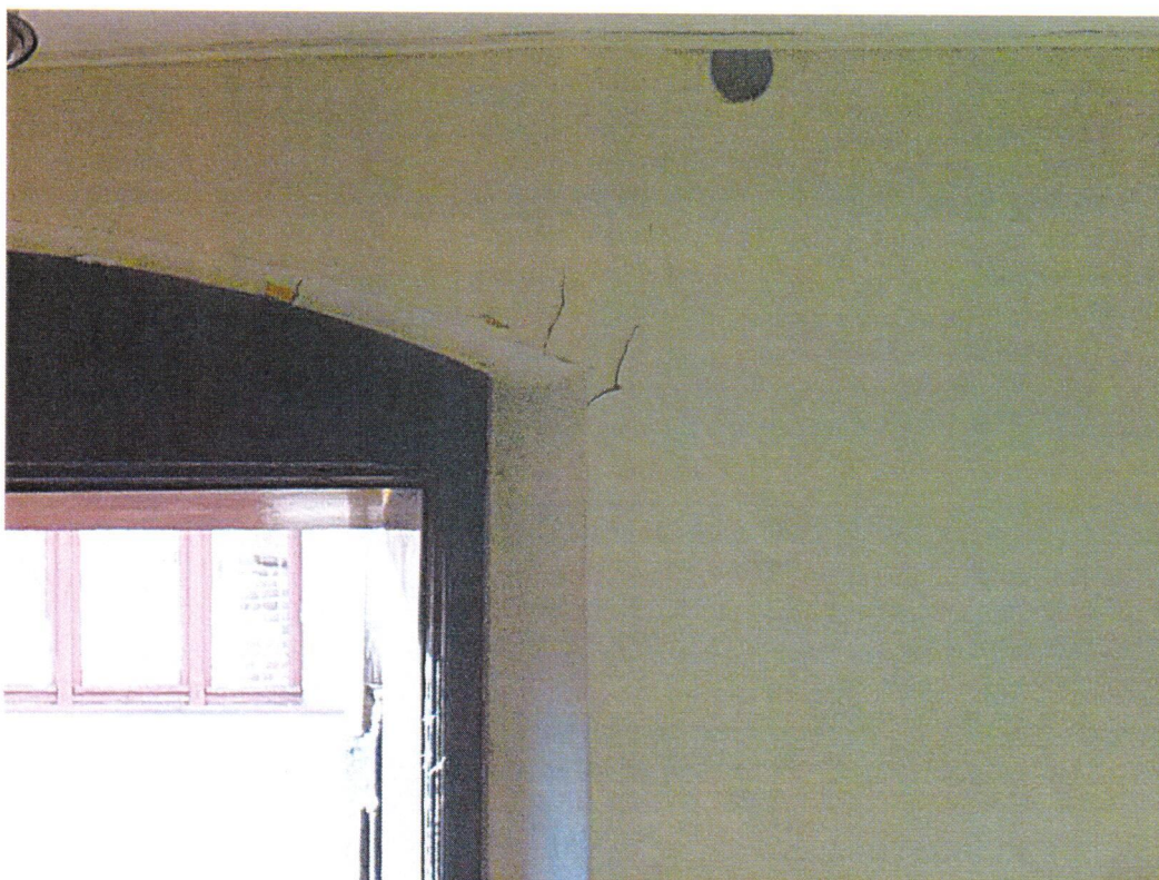
Fot.13. Grudziądz, Kościół pod wezwaniem św. Mikołaja, stan zachowania tynków wewnętrznych.
