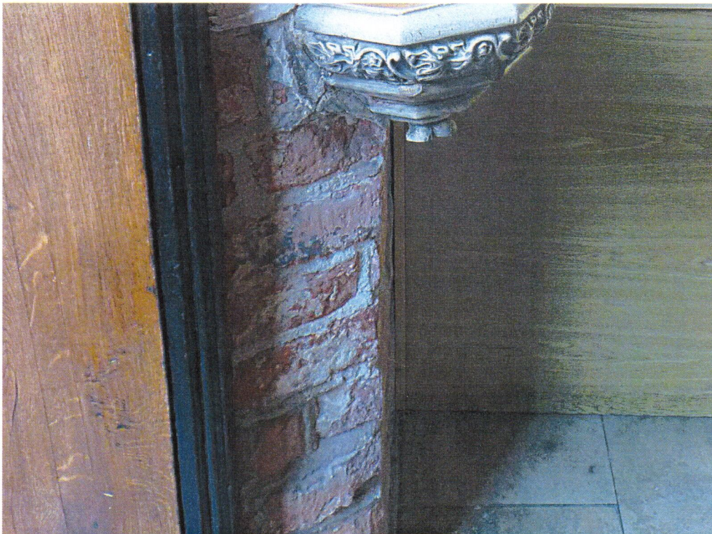
Fot.10. Grudziądz, Kościół pod wezwaniem św. Mikołaja, stan zachowania cegły, widoczna niechlujnie założona spoina i pozostałości zapraw.
