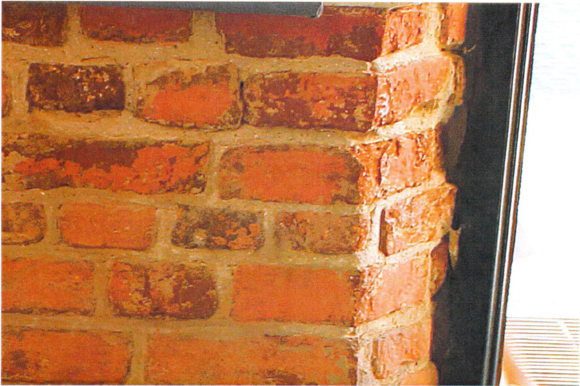
Fot.11. Grudziądz, Kościół pod wezwaniem św. Mikołaja, stan zachowania cegły, cegły o zniszczonej warstwie spieku.
