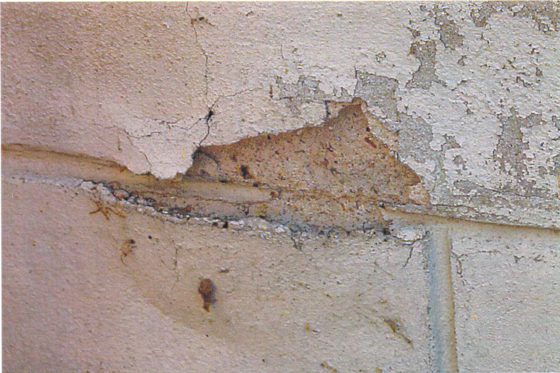
Fot.5. Grudziądz, Kościół pod wezwaniem św. Mikołaja, stan zachowania tynków zewnętrznych – tynk złuszcza się, zaprawa spodnia osypuje się.
