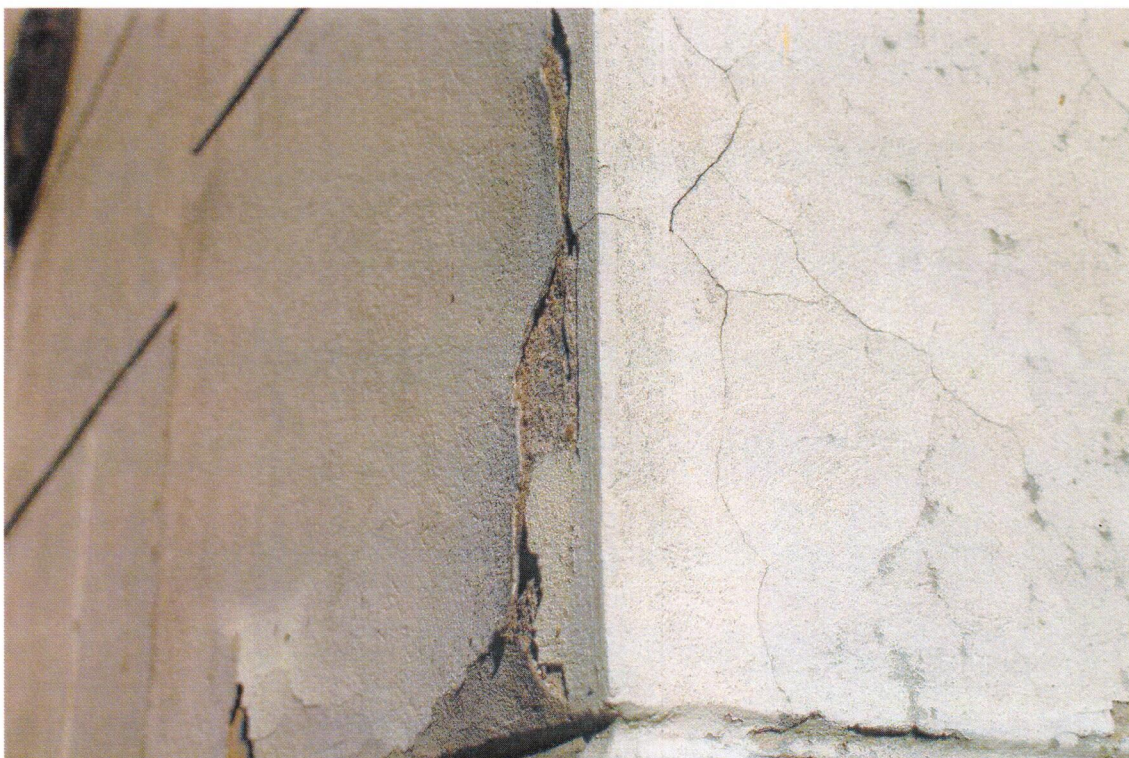
Fot.2. Grudziądz, Kościół pod wezwaniem św. Mikołaja, stan zachowania tynków zewnętrznych, spękania i odspojenia.
