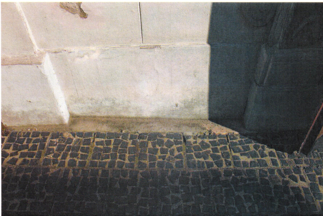
Fot.7. Grudziądz, Kościół pod wezwaniem św. Mikołaja, stan zachowania tynków zewnętrznych, nawarstwienia biologiczne od strony południowej.
