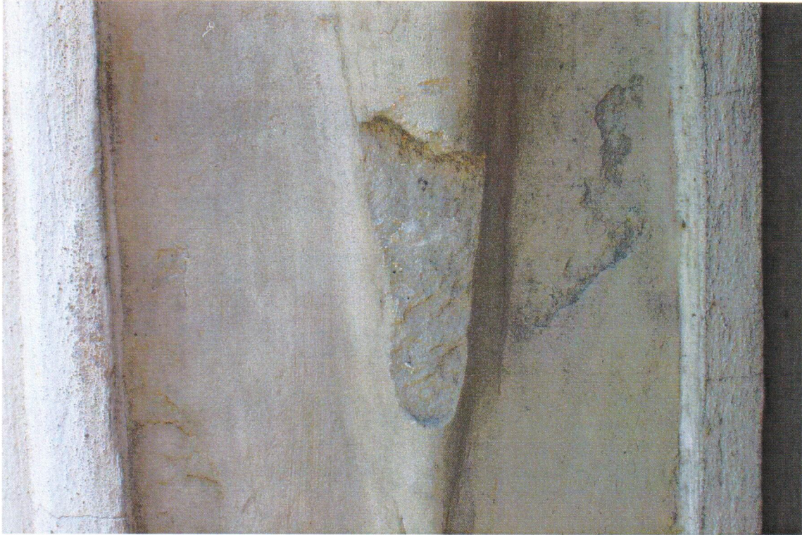
Fot.19. Grudziądz, Kościół pod wezwaniem św. Mikołaja, prawa strona portalu, uszkodzenia mechaniczne w którym widoczna jest struktura naturalnego kamienia.
