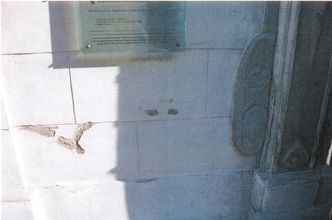
Fot.3. Grudziądz, Kościół pod wezwaniem św. Mikołaja, stan zachowania tynków zewnętrznych, spękania i odspojenia.
