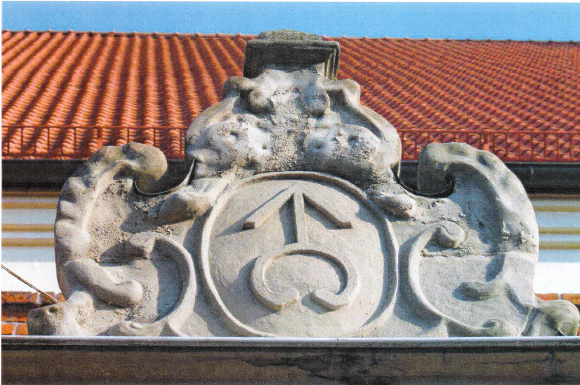
Fot.17. Grudziądz, Kościół pod wezwaniem św. Mikołaja, zwieńczenie kruchty – warstwa powierzchniowej zacierki złuszcza się pod wpływem soli rozpuszczalnych w wodzie.
