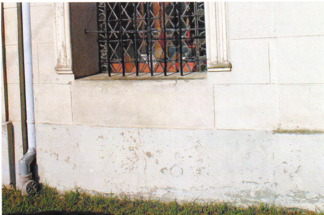
Fot.6. Grudziądz, Kościół pod wezwaniem św. Mikołaja, stan zachowania tynków zewnętrznych, złuszczenia farby na cokole.
