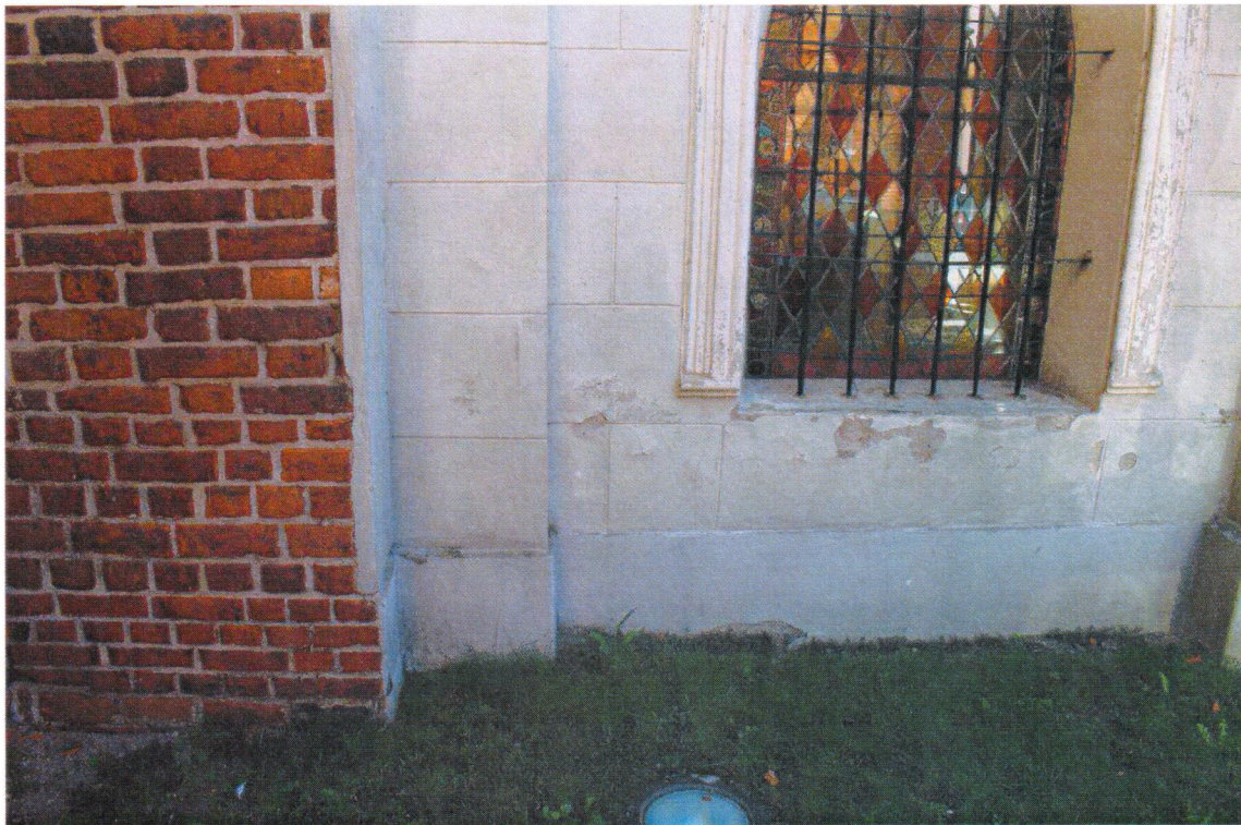
Fot.4. Grudziądz, Kościół pod wezwaniem św. Mikołaja, stan zachowania tynków zewnętrznych, spęcherzenia w strefie podciągania kapilarnego.
