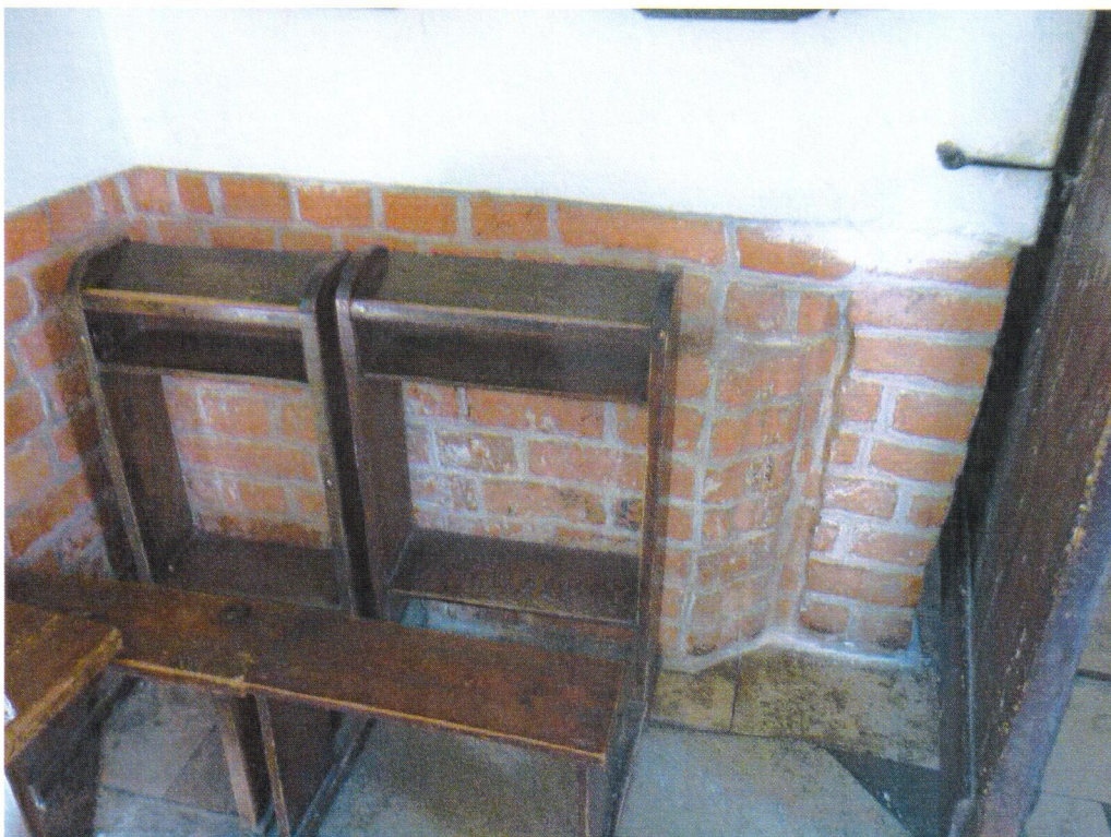
Fot.9. Grudziądz, Kościół pod wezwaniem św. Mikołaja, stan zachowania cegły, widoczne zabrudzenia i pozostałości zapraw mineralnych.
